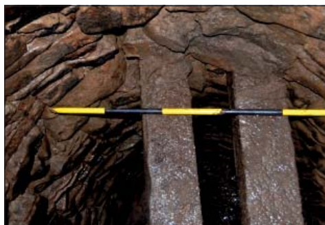
Obr. 7. Masivní dubové trámy ve spodní části studny. Foto T. Chrástek.
