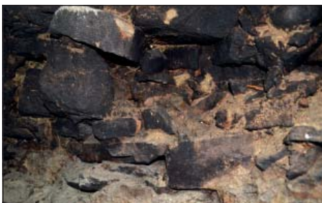
Obr. 9. Detail poškozeného zdiva. Foto T. Chrástek.
