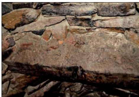
Obr. 8. Dřevěný trám zabudovaný do obvodového zdiva. Foto T. Chrástek.
