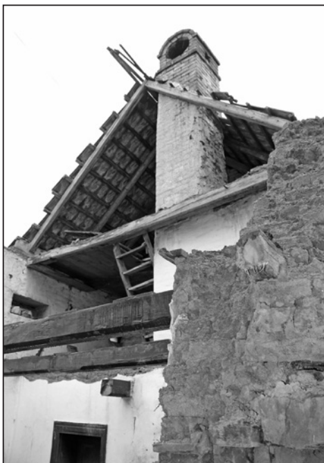
Komínové těleso s udírnou při demolici ve Veletinách čp. 120, 2013. Foto J. Káčer, fotoarchiv Parku Rochus, o.p.s.
