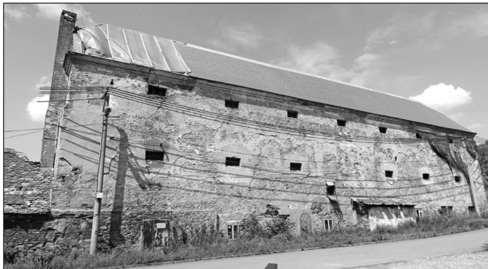
Pohled na objekt od východu ukazuje, že střecha je již téměř opravená, Louka 2015. Foto D. Hodeček.
