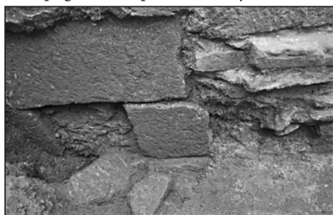
Obr. 9. Detail dvou proluk v hradbě sloužících k odtoku dešťové a odpadní vody ven z města Foto J. Bartík.
