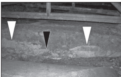
Obr. 9. Hrad Buchlov, půda, detail západního líce zdi, dělicí v 1. patře místnosti č. 24 a 25; bílé šipky ukazují na pozůstatky interiérových omítek dvojice klenebních čel, černá šipka míří na vodorovnou hranu, kterou je ukončena plocha omítek mladších, souvisejících s rovným stropem nad místností č. 25; pohled od západu, Buchlov 2012. Foto R. Vrla.
