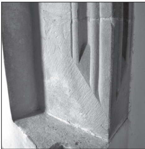
Obr. 11. Hrad Buchlov, trnož části ostění vstupního portálu do bývalé raně gotické kaple, pohled od severovýchodu, Buchlov 2012. Foto R. Vrla.
