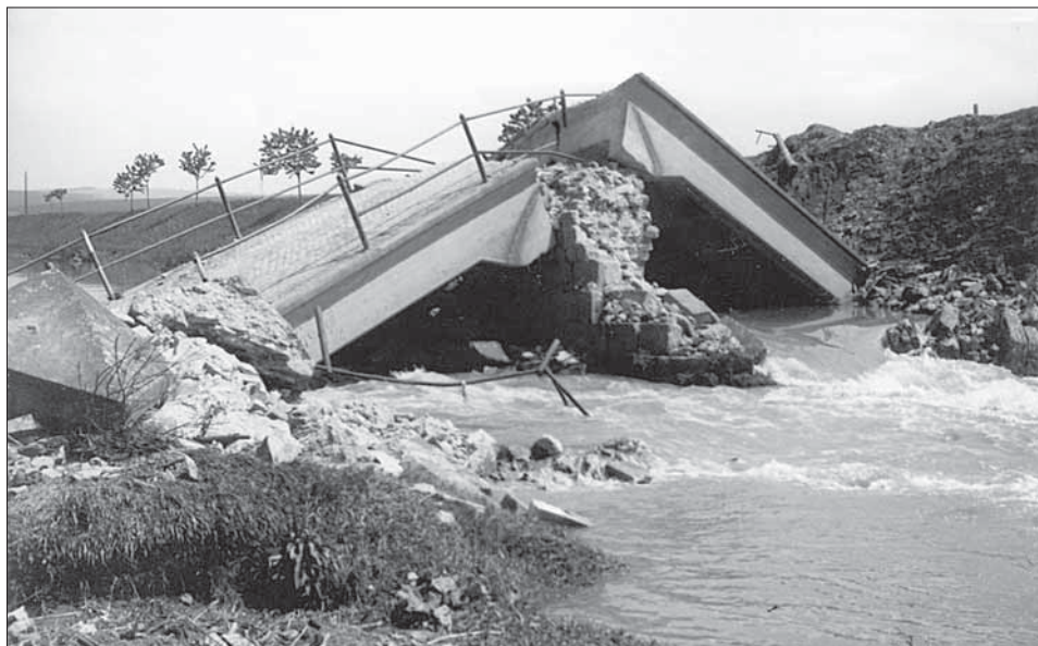
Šumický most po přechodu fronty.
