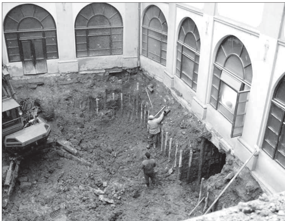
18. Pohled na průběh zemních prací na zámeckém nádvoří, na profilu zachyceny pozdně středověké vrstvy. Foto J. Kohoutek.
