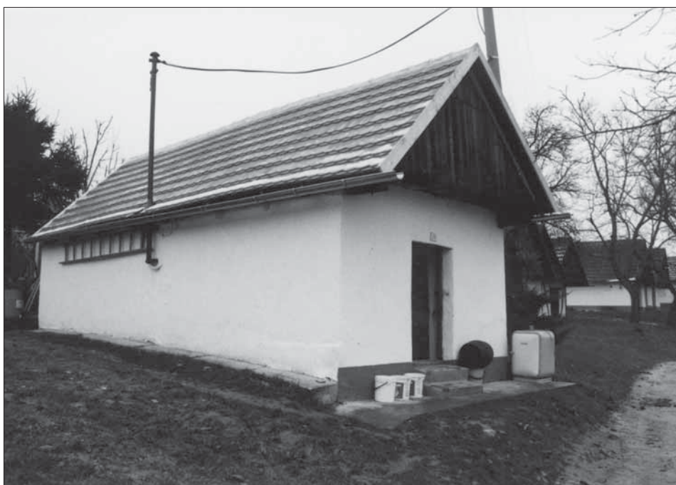
10. Obnovená střecha a štít vypovídá, že došlo k celkovému zhodnocení památky. Vlčnov.
